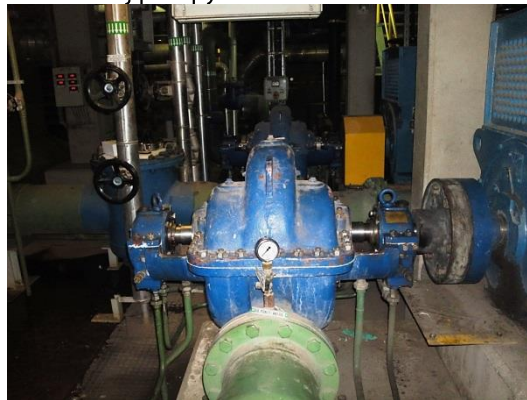
Przewałowa Pompa 25B32 w elektrowni
