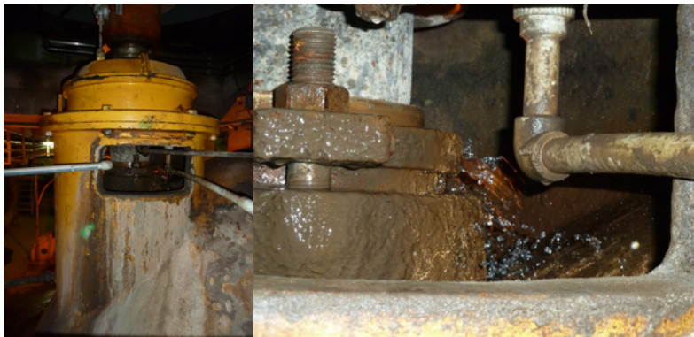
Typowy obraz przy stosowaniu szczeliwa w pompach
